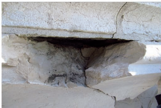
Distacco parziale di porzione lapidea del basamento
