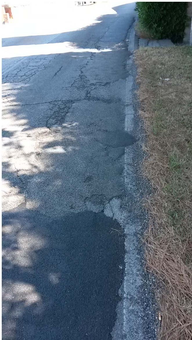
asfalto degradato in molte strade del Lido
